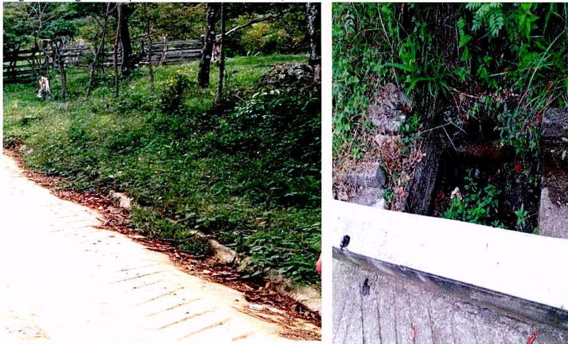
— Cuneta que requiere mantenimiento
